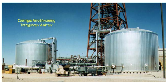
Σχήμα 2.11 Τυπικό Σύστημα Αποθήκευσης Θερμής και Ψυχρής Δεξαμενής Τετηγμένων Αλάτων του Σταθμού Solar Two. [44]
