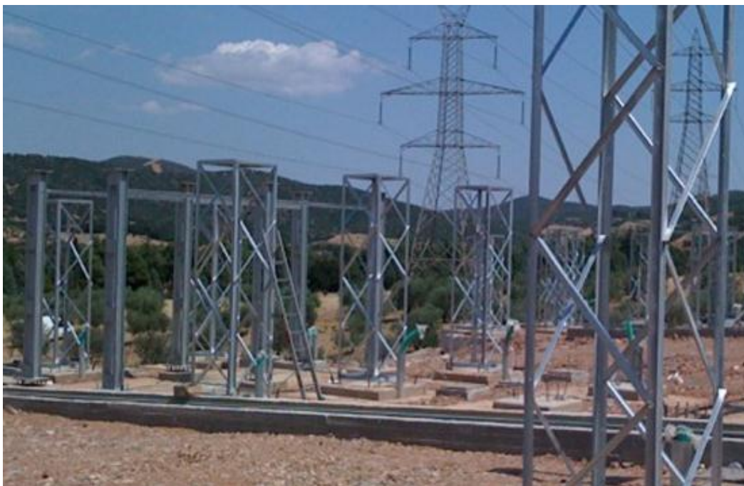
Εικόνα 12.1. Υποσταθμός Δ.Ε.Η. Μέσης Τάσης
