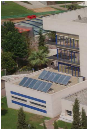
Εικόνα 8.14: Αεροφωτογραφία του συστήματος ηλιακού κλιματισμού στη Γρανάδα της
