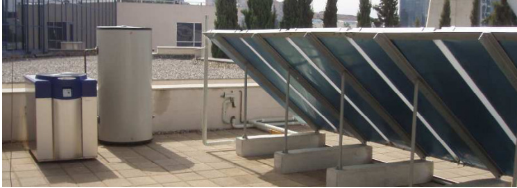
Εικόνα 8.13: Σύστημα ηλιακού κλιματισμού εγκατεστημένο σε στέγη στη Γρανάδα της Ισπανίας
