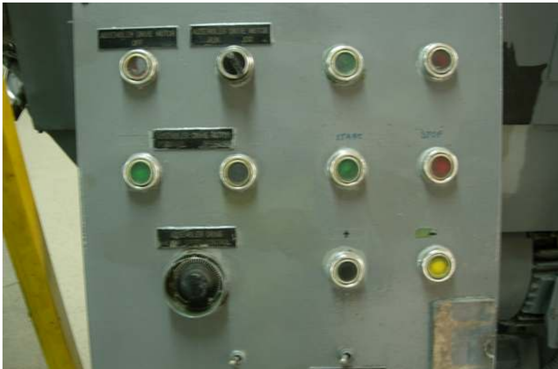
Σχήμα 1.22. Πίνακας ελέγχου του εκβολέα
