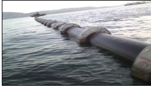
Εικόνα 3.3 Αγωγοί Διάθεσης (πηγή: Αρχείο Βιολογικού Καθαρισμού Θριασίου Πεδίου)
