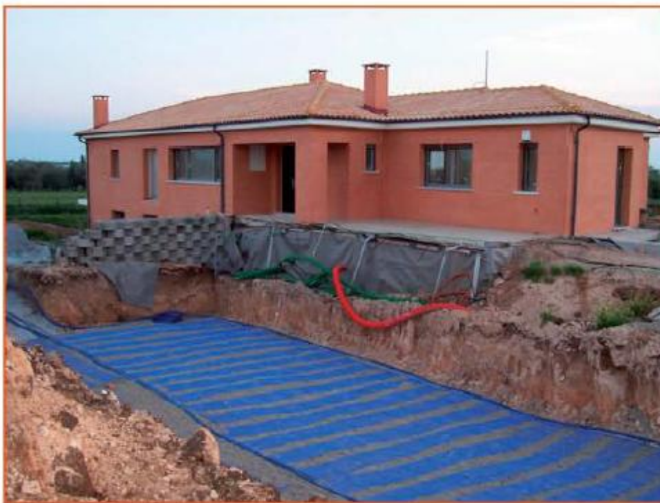
Εικόνα 3.7: Χρήση συστήματος γεωθερμικής αντλίας θερμότητας ( τοποθέτηση κλειστού οριζόντιου συστήματος γεωεναλλάκτη) για την κάλυψη των θερμικών αναγκών μονοκατοικίας 220 m 2 στην περιοχή Αγγελοχωρίου Θεσ/νίκης (στάδιο κατασκευής). Πηγή: ΚΑΠΕ
