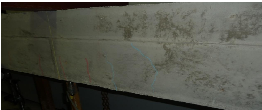
Σχήμα 4-13 Οι κύριες ρωγμές στη δοκό με οπλισμό C-FRP
