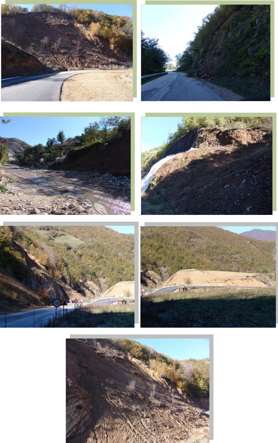
Σχήμα 6.21 Χαρακτηριστικές κατολισθήσεις στην περιοχή έρευνας.
