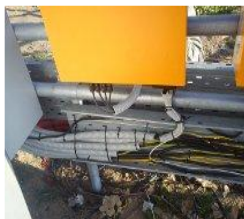
Διαδρομή παροχικών καλωδίων inverter προς το γενικό πίνακα μέσα σε σωλήνες
