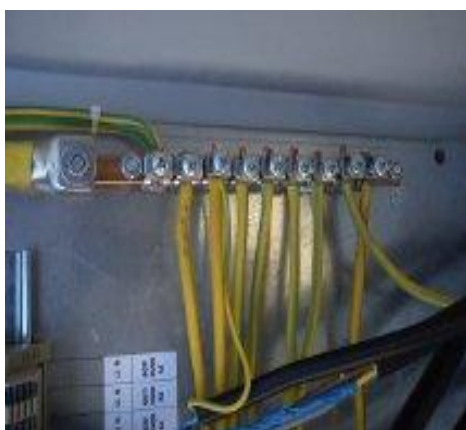
Μπάρα γειώσεων γενικού πίνακα
