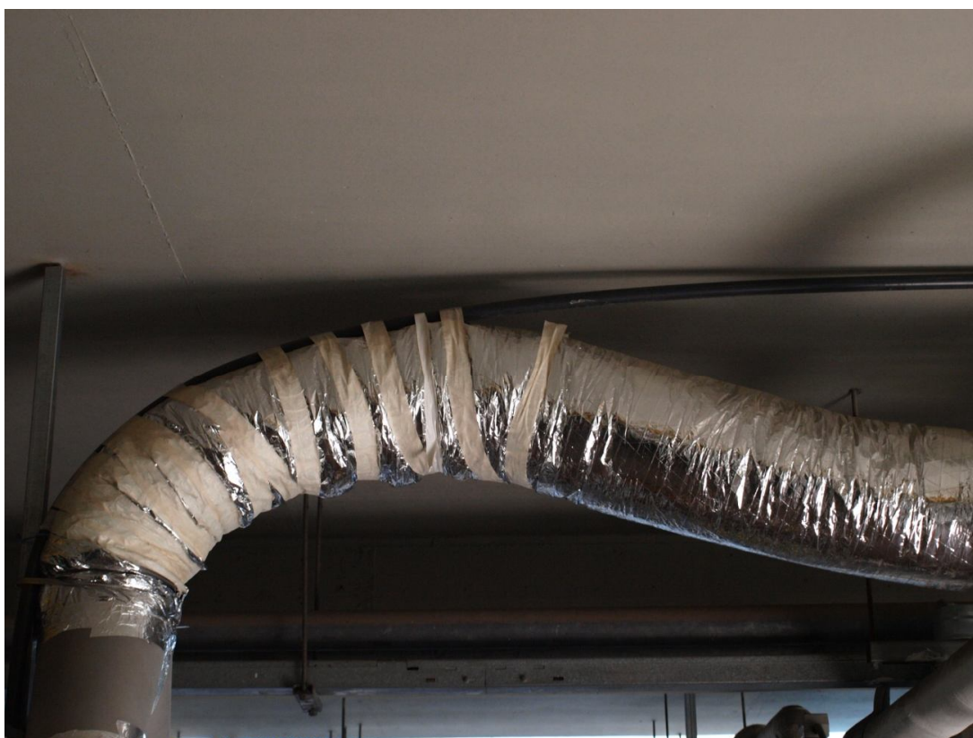
6. Αμβλεία γωνία αεραγωγού
