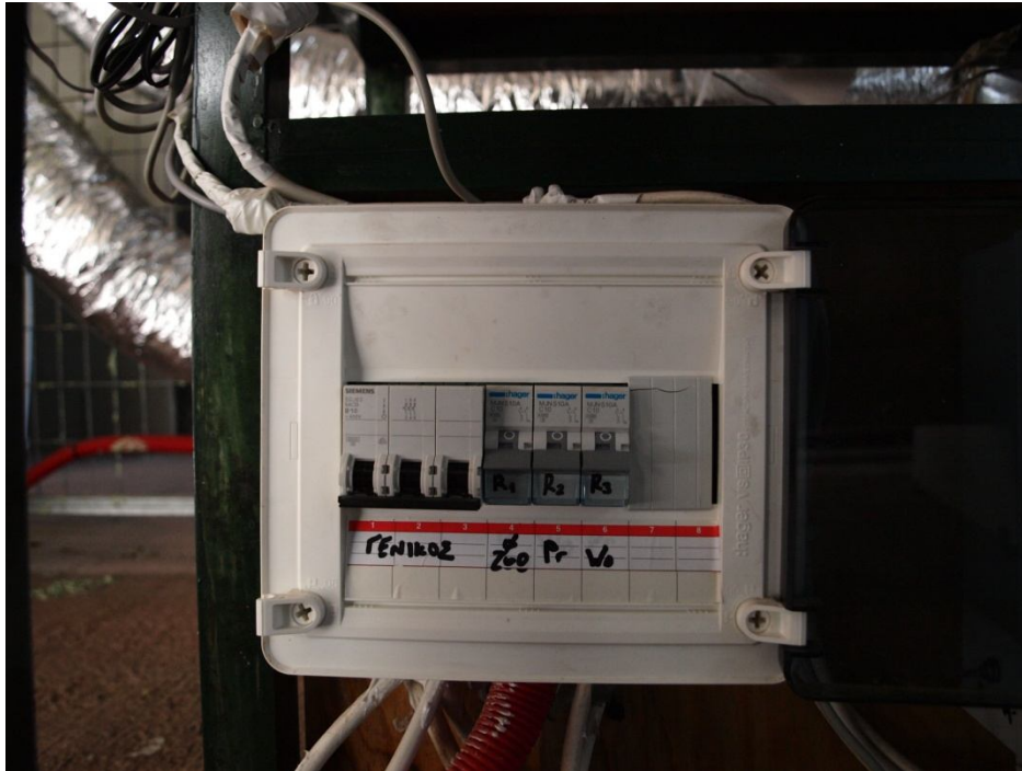
15. Ηλεκτρικός πίνακας διατάξεως
