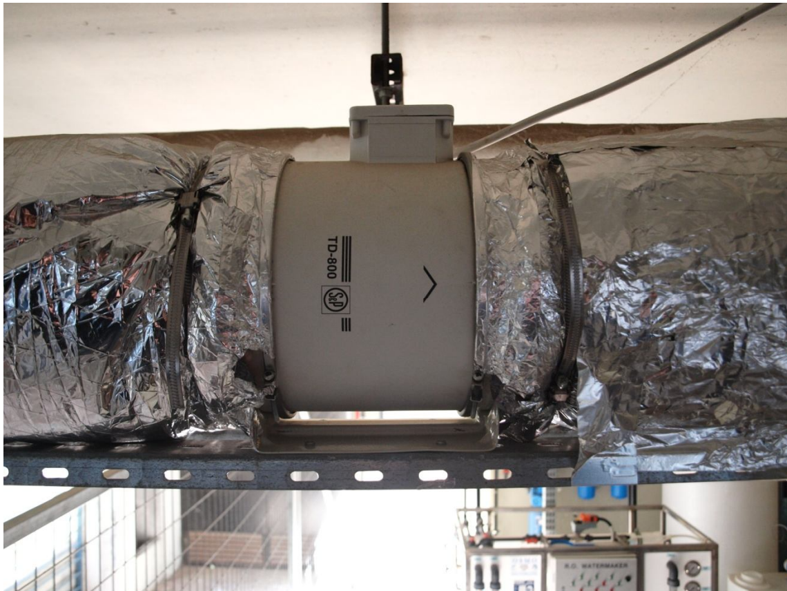
2. Ηλεκτρικός ανεμιστήρας απορρόφησης αέρα
