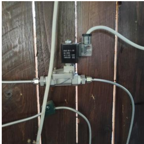
Εικόνα16: Ηλεκτροβάνα για τη διακοπή παροχής αερίου υδρογόνου
