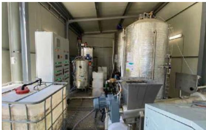
Εικόνα 10: Μονάδα επεξεργασίας αστικών λυμάτων (WWTP) του δήμου Δυτικής Αχαΐας
