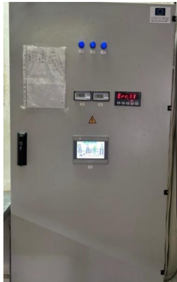
Εικόνα 25: Πίνακας Ελέγχου PLC
