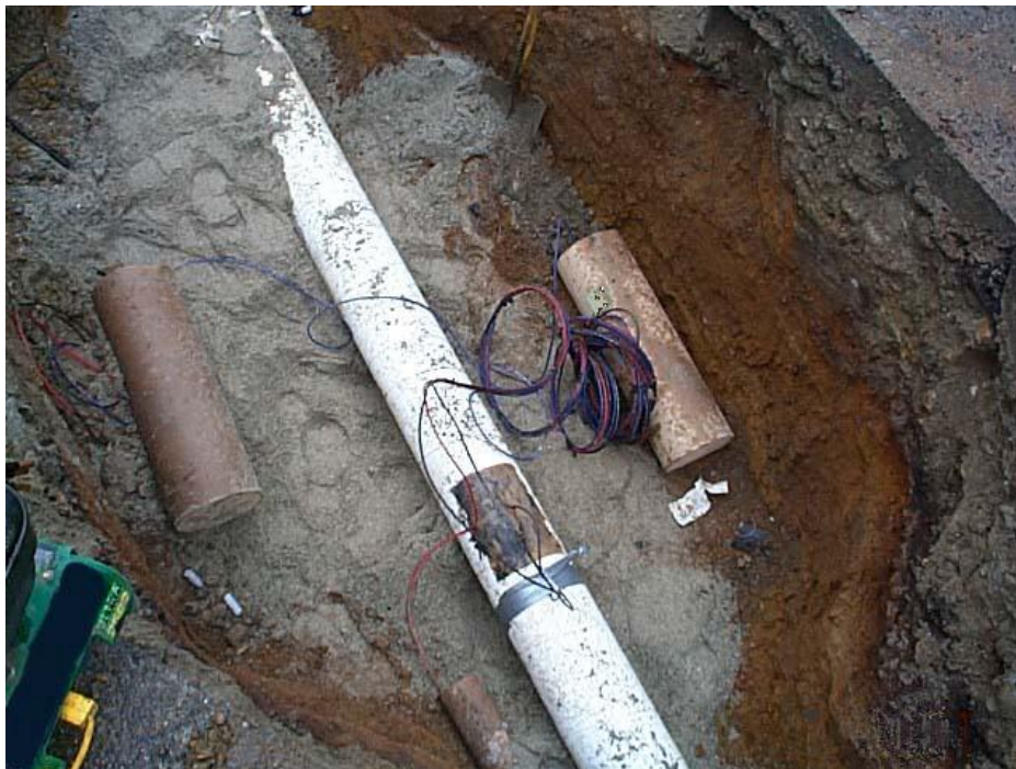
Εικόνα 4. 1.: Σύστημα Καθοδικής Προστασίας Θυσιάζομενων Ανόδων
