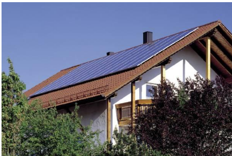
Εικόνα 5.8 – Φωτοβολταϊκά πλαίσια σε κεραμοσκεπή
