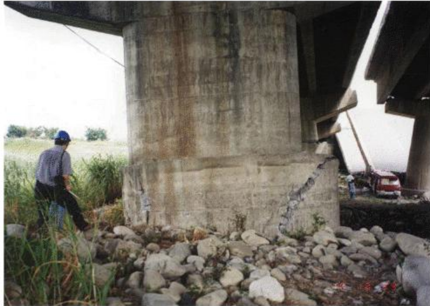
Εικόνα 1.7 : Διατμητική αστοχία του φρέατος θεμελίωσης του βάθρου P3W της γέφυρας Wu - Shi κατά το σεισμό του Chi – Chi (Taiwan 1999).
