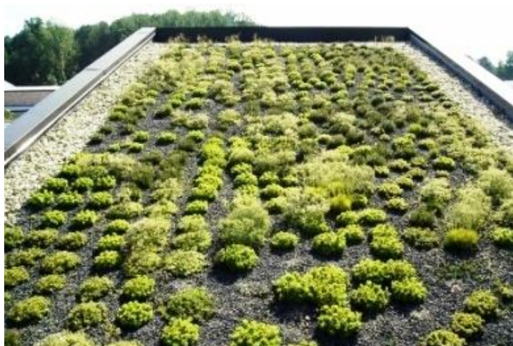
Εικόνα 4.2 ΟΛΠ, Φυτεμένο Δώμα (πηγή: ΟΛΠ)
