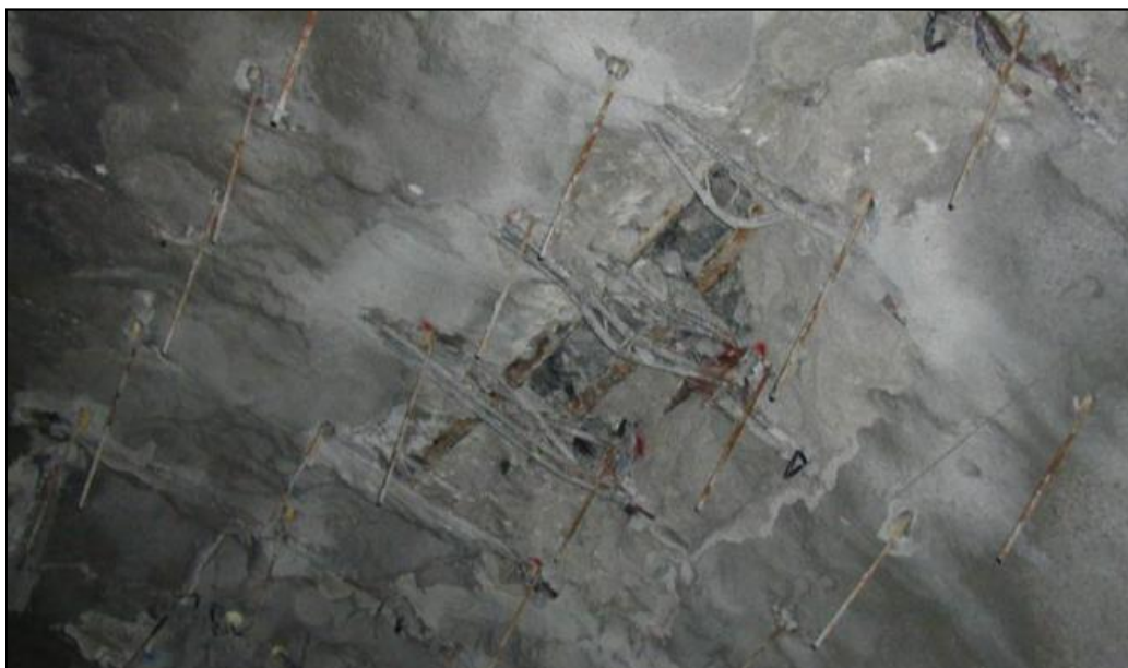
Σχήμα 4.4 Αστοχία των πλαισίων Lattice Girder στη σήραγγα Ανθοχωρίου λόγω υπερφόρτισης του κελύφους της υποστήριξης (Πηγή: TIAS, Μαρίνος et al., 2006, Μαρίνος Β., 2007, Marinos et al., 2010).
