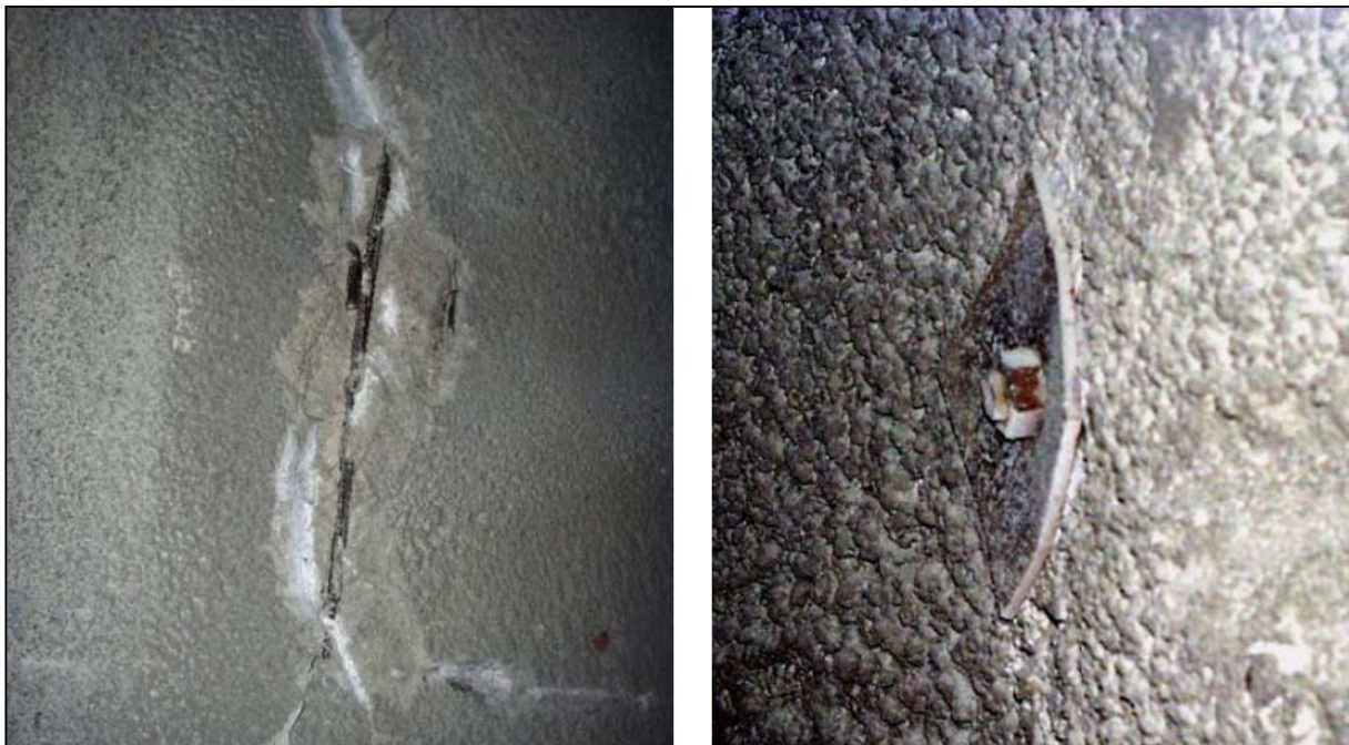
Σχήμα 4.9 Σήραγγα Δρίσκου. Αστοχία σκυροδέματος σε περιοχή κοντά σε μεταλλικό πλαίσιο και παραμορφωμένη πλάκα αγκυρίου εξαιτίας της υπερφόρτισης της υποστήριξης.
