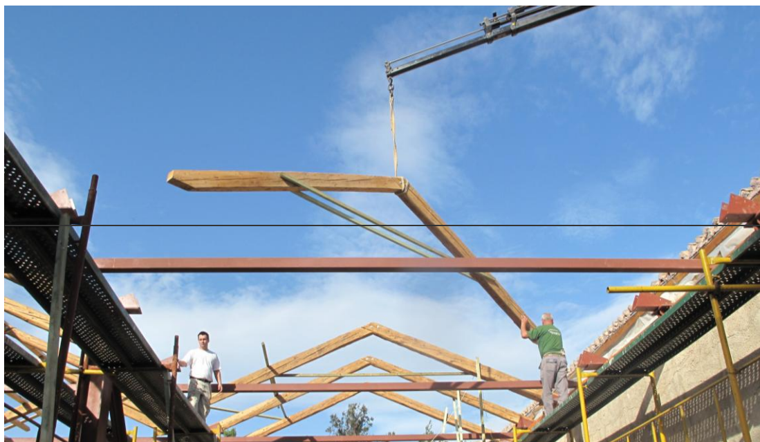
Εικόνα 13 Τμήμα φέροντα οργανισμού έχει κατασκευαστεί στο έδαφος και τοποθετείται στη θέση του
