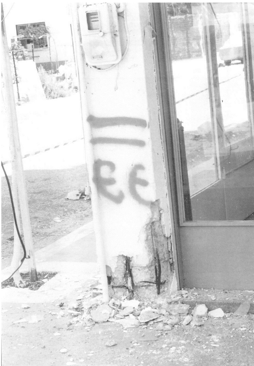
Εικ.2.1 Θραύση γωνιακού υποστυλώματος εξαιτίας έλλειψης συνδετήρων (Ροβήλος, 2001)
