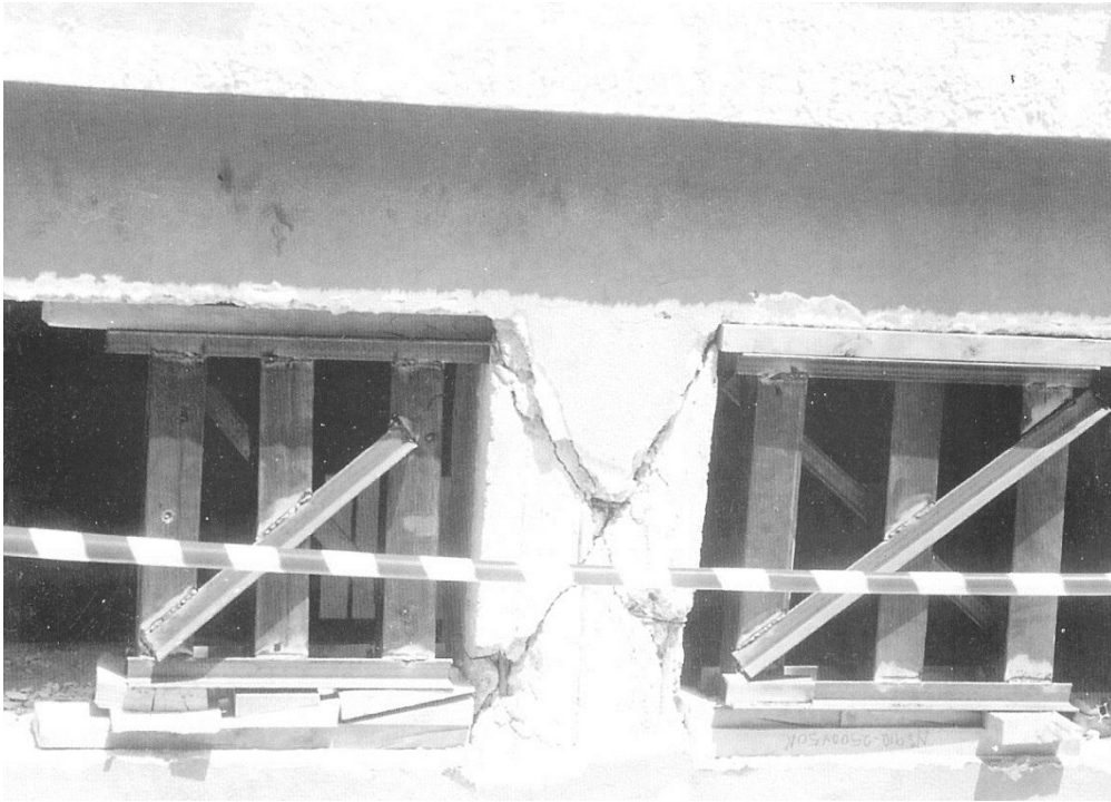
Εικ.2.3 Τυπική μορφή θραύσης κοντών υποστυλωμάτων (Ροβήλος, 2001)
