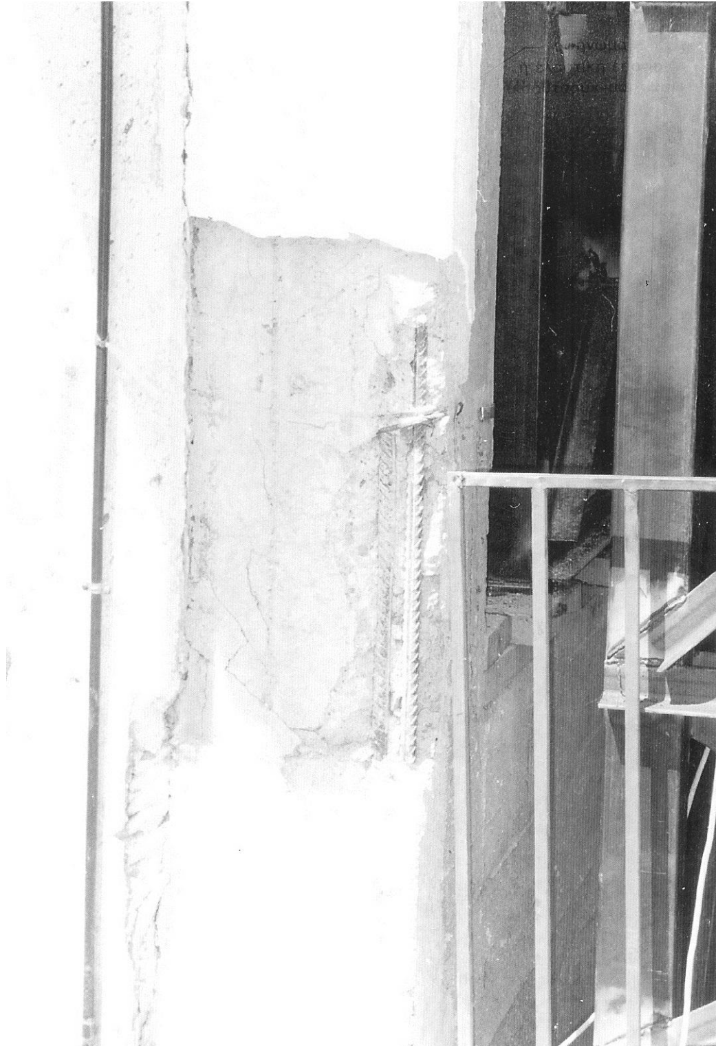
Εικ.2.2 Ρηγμάτωση γωνιακού υποστυλώματος στη βάση του εξαιτίας έλλειψης συνδετήρων (Ροβήλος, 2001)
