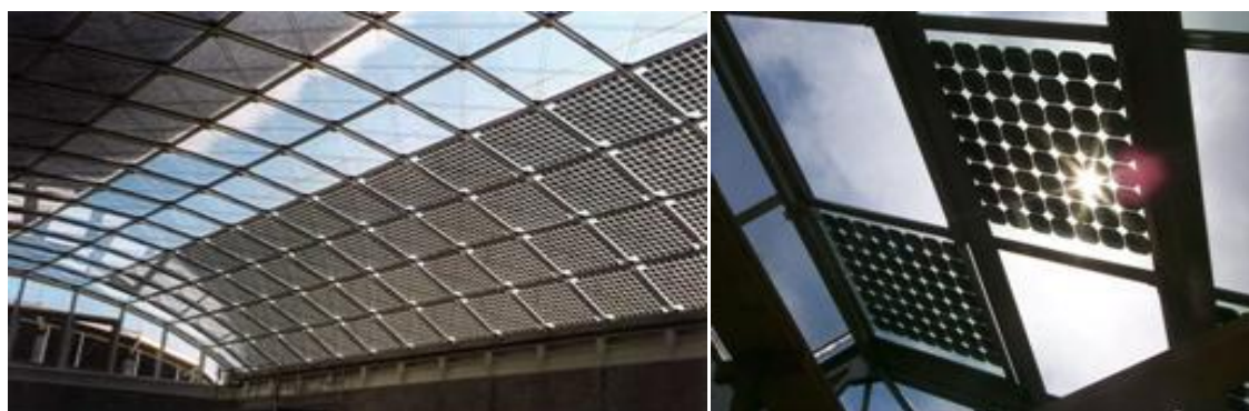
Εικόνα 1.9: Φωτοβολταϊκοί υαλοπίνακες σε οροφές κτιρίων
