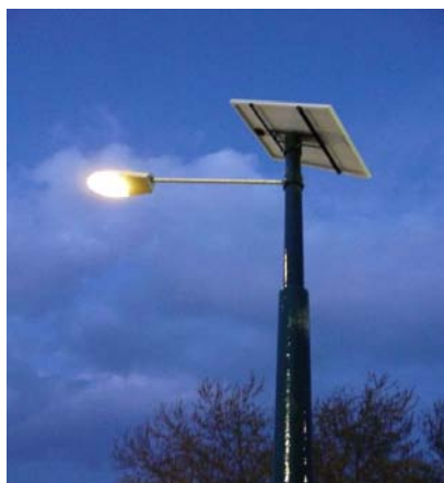
Σχήμα 5.13: Φωτοβολταϊκή κολώνα οδικού φωτισμού
