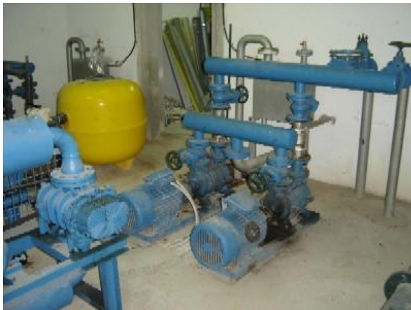
Εικόνα 5.14 Τυπική εγκατάσταση αντλιοστασίου μεσαίας ονομαστικής ισχύος
