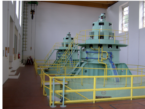
Εικ. 26 Ηλεκτρομηχανολογικός εξοπλισμός FRANCO TOSI (1953), Φωτογραφία 2012 πηγή: Αρχείο Λύτη Αλέξανδρου
