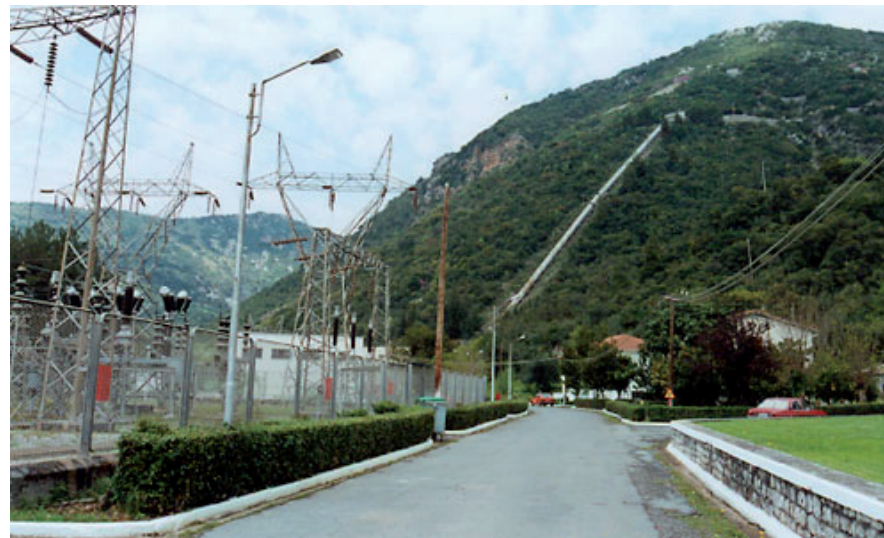
Εικ. 31. Ο κεντρικός δρόμος προς το Σταθμό Παραγωγής. Αριστερά φαίνεται ο Υποσταθμός Μετασχηματισμού της Τάσης. Αριστερά, η σχέση των σπιτιών με το δρόμο δίνει την εντύπωση ελληνικής επαρχίας.
