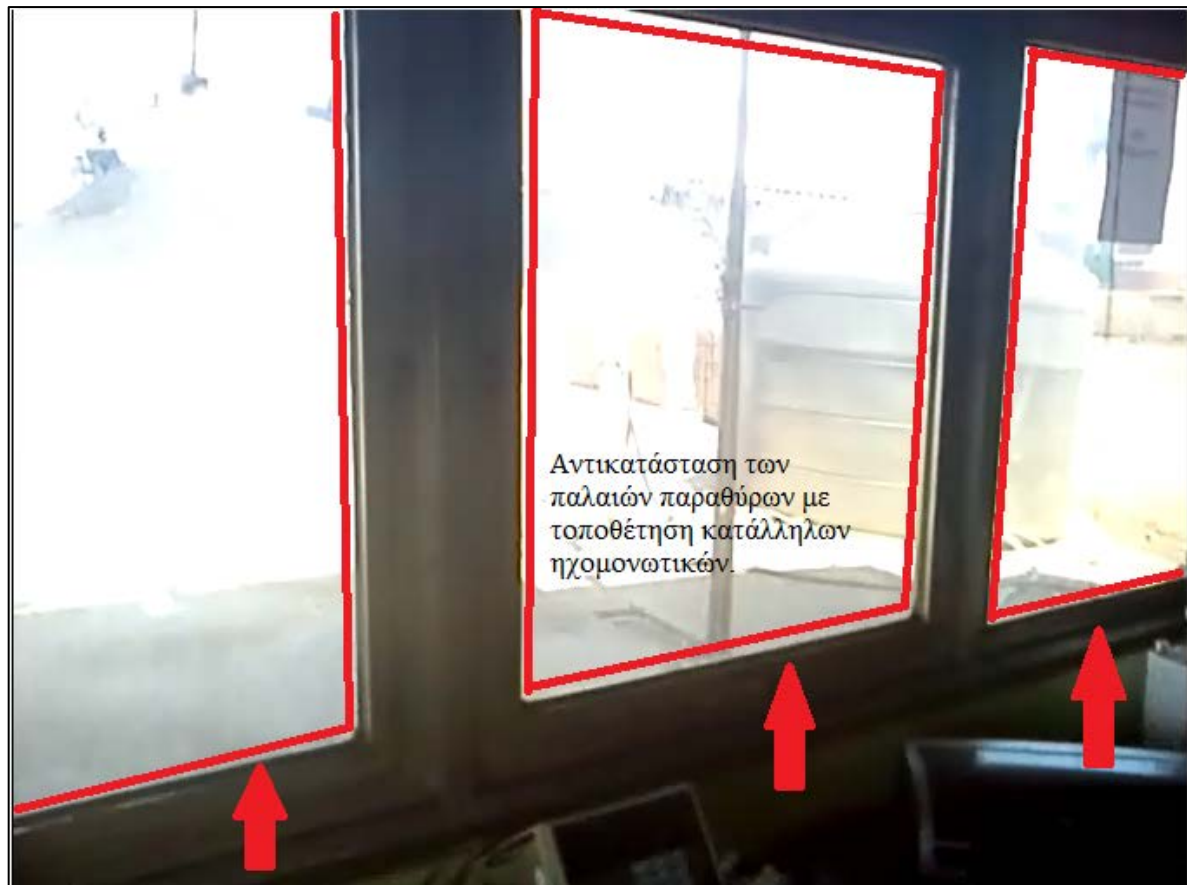
Εικόνα 4-14: Μη κατάλληλα ηχομονωτικά τζάμια στο ζυγιστήριο
