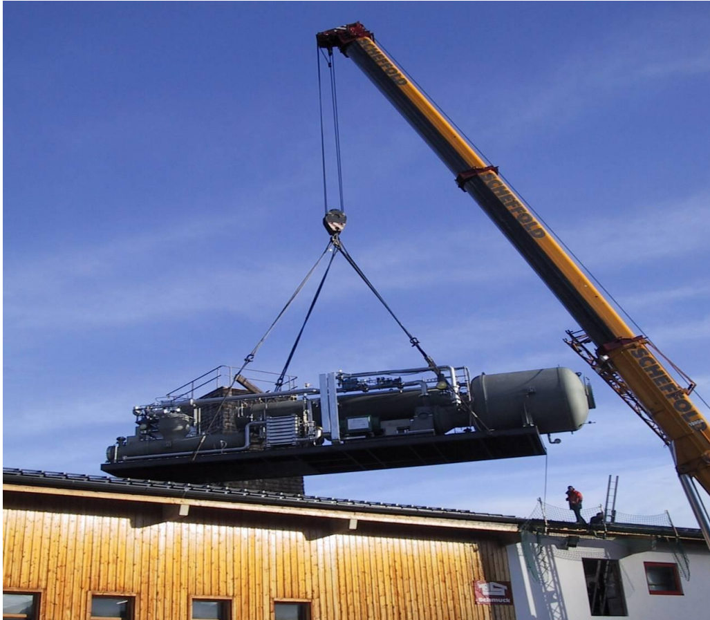
Σχήμα 15.11 Εγκατάσταση συστήματος ORC [54]
