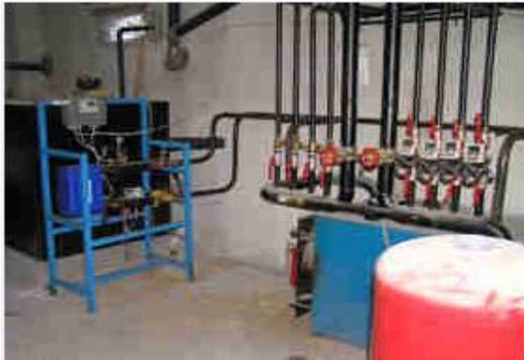
Εικόνα 4.4: Τυπικός θερμικός υποσταθμός καταναλωτή
