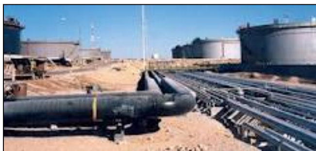
Εικόνα 2-10: Σωληνοδιάδρομος επί βάσεων τσιμέντου
