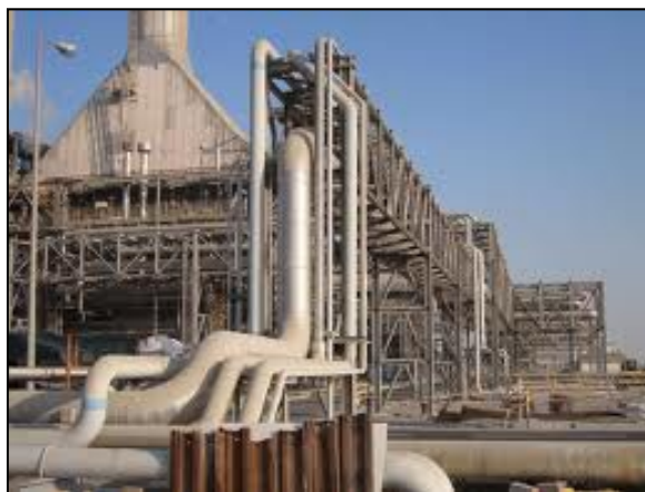
Εικόνα 2-11: Σωληνοδιάδρομος επί υπερυψωμένης σιδηροκατασκευής
