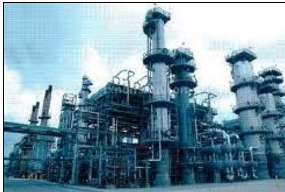
Εικόνα 2-13: Μονάδα (δοχεία, δεξαμενές, εναλλάκτες, σιδηροκατασκευές)
