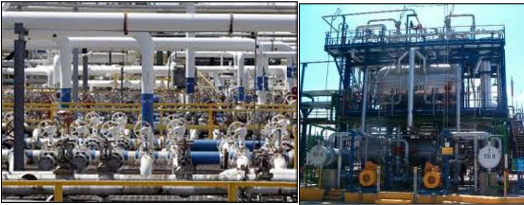
Εικόνα 2-12: Εξοπλισμός ( αντλίες, συλλέκτες βάνες και όργανα ροής και θερμοκρασίας )
