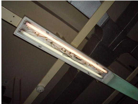
Σχήμα 5.10 : Φωτιστικό σώμα στο οποίο έχει αφαιρεθεί το διαχτυτικό κάλυμμα με σκοπό την αύξηση της φωτεινής ροής του λαμπτήρα.
