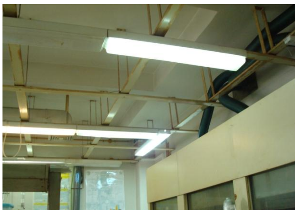
Εικόνα 6.1: Απαρχαιωμένα φωτιστικά σώματα χωρίς ανακλαστήρες
