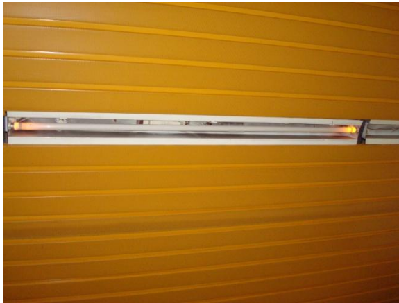
Σχήμα 5.10 : Διαρροή ηλεκτρικού ρεύματος μέσα από λαμπτήρα που δεν λειτουργεί λόγω ηλεκτρομαγνητικού ballast.
