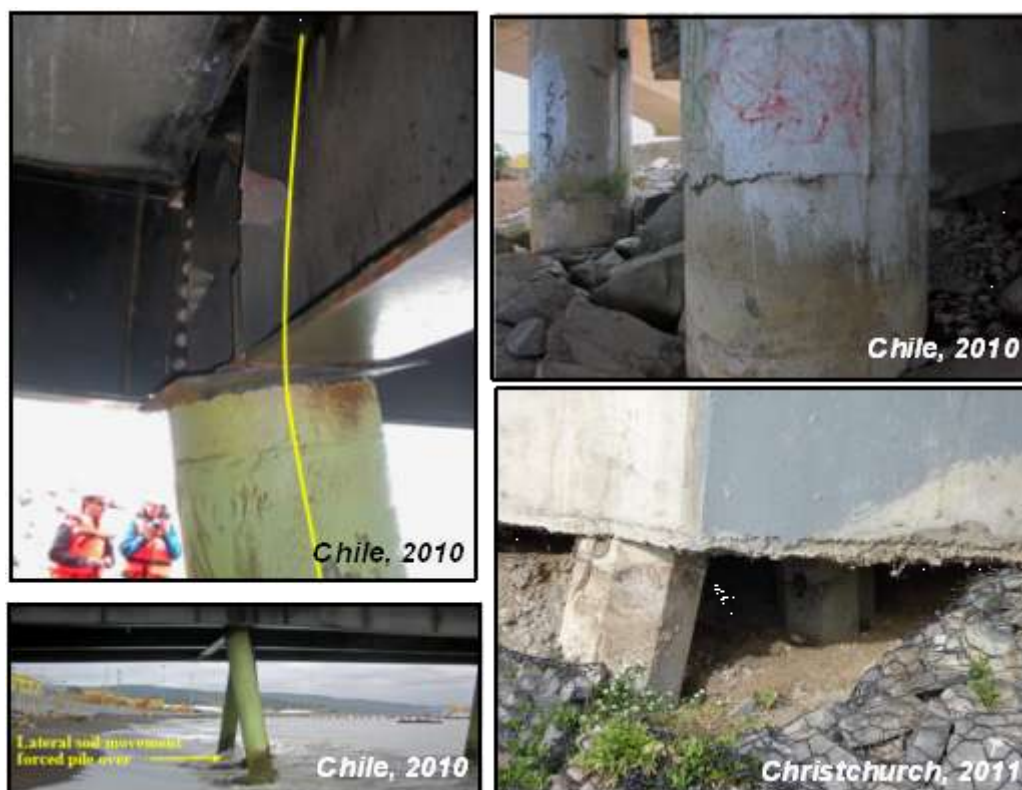
Σχήμα 4: Παραδείγματα αστοχίας πασσάλων λόγω ρευστοποίησης και πλευρικής εξάπλωσης του εδάφους σε πρόσφατους ισχυρούς σεισμούς.
