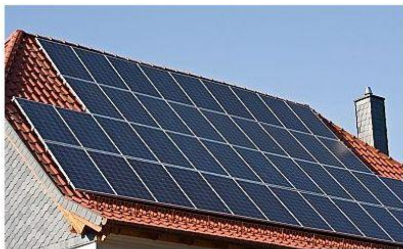
Εικ. 4.11 Φωτοβολταϊκά σε στέγη
