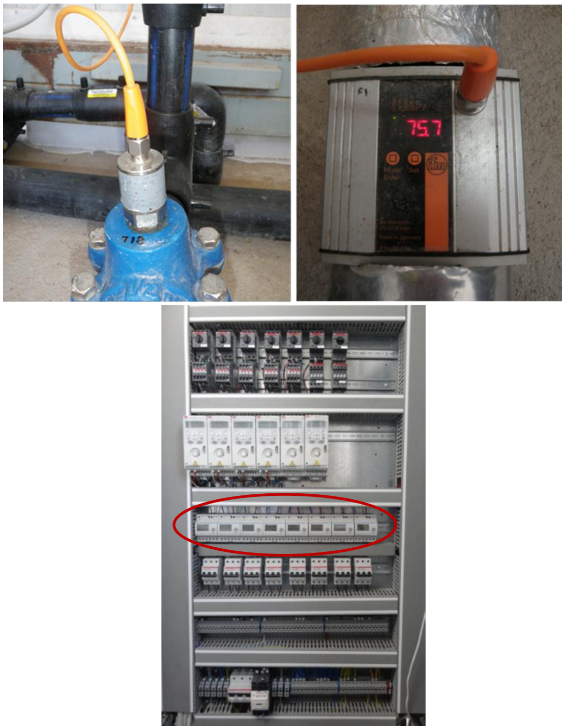
Εικόνα 1.2.4 Αισθητήριο Θερμοκρασίας T18, Ροόμετρο F1, Μετρητές Ηλεκτρικής Ενέργειας
