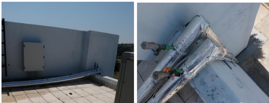
Εικόνα 1.4.2 Πίνακας Κεντρικού Κτηρίου , Σωληνώσεις από/προς το Κτήριο
