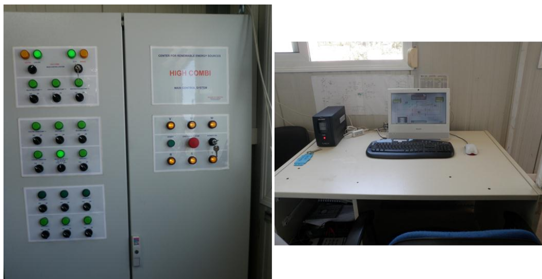
Εικόνα 1.2.2 Κεντρικός Πίνακας , Υπολογιστής Εγκατάστασης
