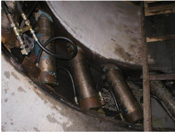
Εικόνα 3. 43: Σχετική περιστροφή του σταθμού και καταστροφή αυτού (12)
