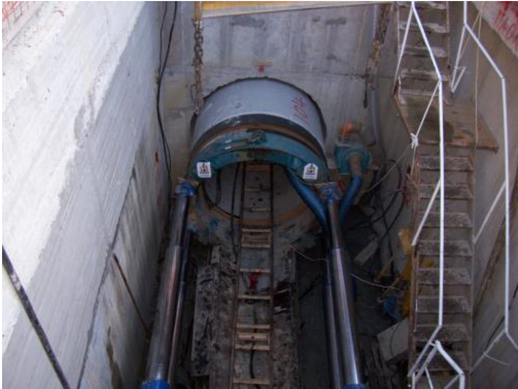
Εικόνα 3. 22: Κύριος σταθμός ώθησης (12).
