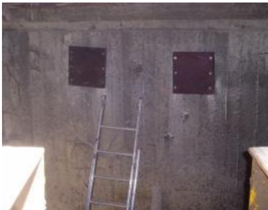
Εικόνα 4. 30: Στερέωση με κοχλίες των επίπεδων μεταλλικών πλακών στο απέναντι τοίχιο του πλακοσκεπούς αγωγού (9).
