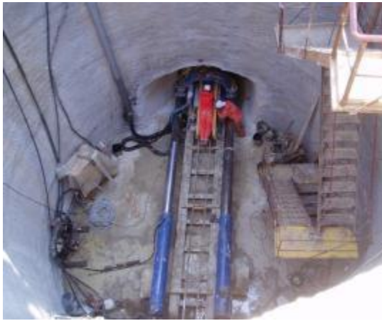
Εικόνα 1. 37: Κύριος σταθμός ώθησης σε πλήρη έκταση των εμβόλων (9).
