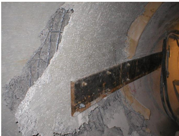
Εικόνα 3. 44: Κατεστραμμένη σύνδεση σωλήνα. (12)
