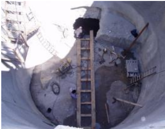
Εικόνα 4. 28: Επέκταση της βάσης τοποθέτησης του μηχανήματος για την γεφύρωση του πλακοσκεπούς αγωγού (9).
