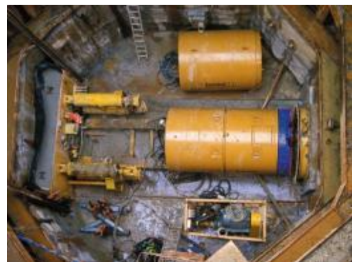
Εικόνα 1. 40: Κύριος σταθμός ώθησης σε εν σειρά διάταξη εμβόλων και σωλήνα.
