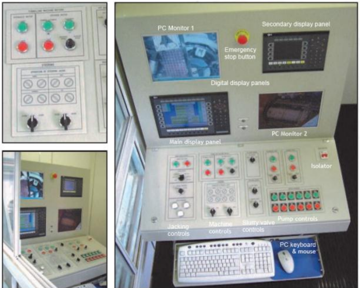
Εικόνα 1. 29: Διάταξη του πίνακα ελέγχου μηχανήματος MT.
