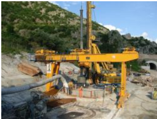
Εικόνα 3. 36: Εγκαταστάσεις φρεατίου Φ3 (12).
