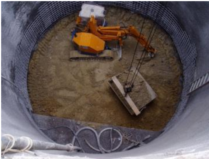
Εικόνα 4. 26: Εκσκαφή φρεατίου εργασίας στην Λ. Κνωσού. Διακρίνεται η οροφή του πλακοσκεπούς αγωγού (9).
