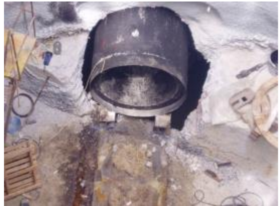
Εικόνα 4. 22: Ο αγωγός πίσω στο φρεάτιο της Α. Κνωσού (9).
