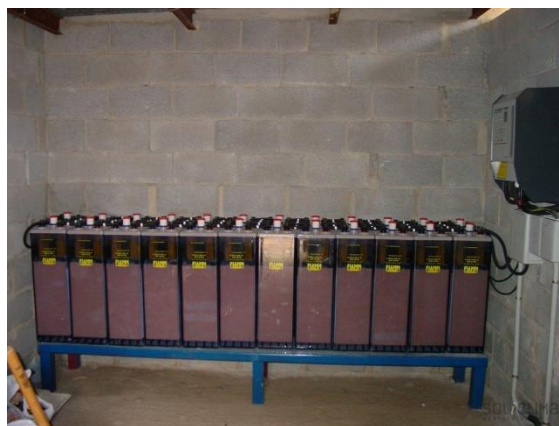
Σχήμα 4.2.1:Εγκατεστημένη συστοιχία μπαταριών φωτοβολταϊκού συστήματος
