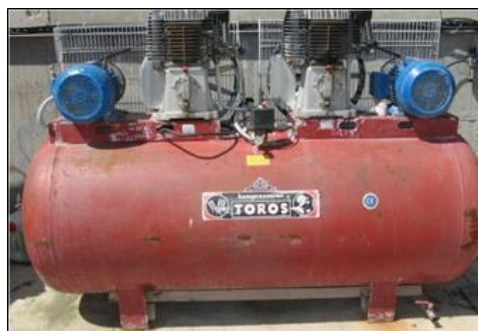
Εικόνα 3.20: Αεροσυμπιεστής και αεροφυλάκιο.
