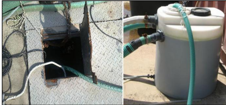
Εικόνα 3.13: Σημείο τροφοδοσίας (αριστερά) και Δεξαμενή Τροφοδοσίας Λυμάτων (ΔΤΛ) (δεξιά)
