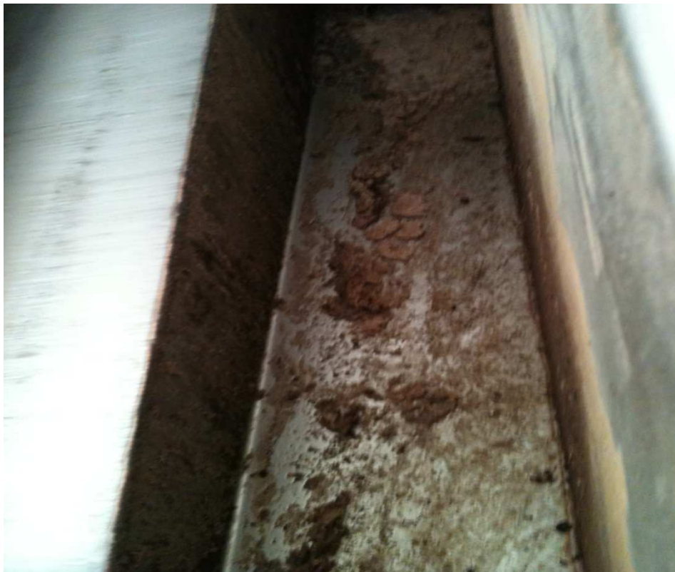
Σχήμα 15: Κανάλι ξαφρισμάτων το οποίο βρίσκεται μετά επιφανειακό ζέστρο της μονάδας DAF.
