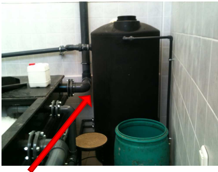
Σχήμα 19: Δεξαμενή καθαρών αποβλήτων της βιομηχανικής μονάδας μετά την επεξεργασία με MBR.
