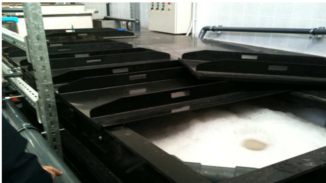
Σχήμα 17: Δεξαμενή αερισμού βιομηχανικής μονάδας.
