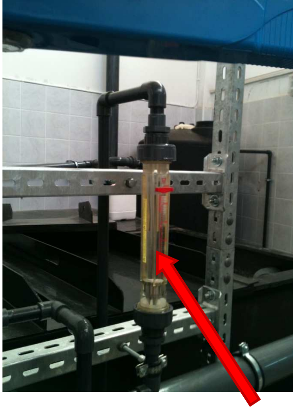
Σχήμα 20 : Μονάδα παρακολούθησης παροχής των λυμάτων της βιομηχανικής μονάδας μετά την επεξεργασία MBR προς δεξαμενή καθαρών.
