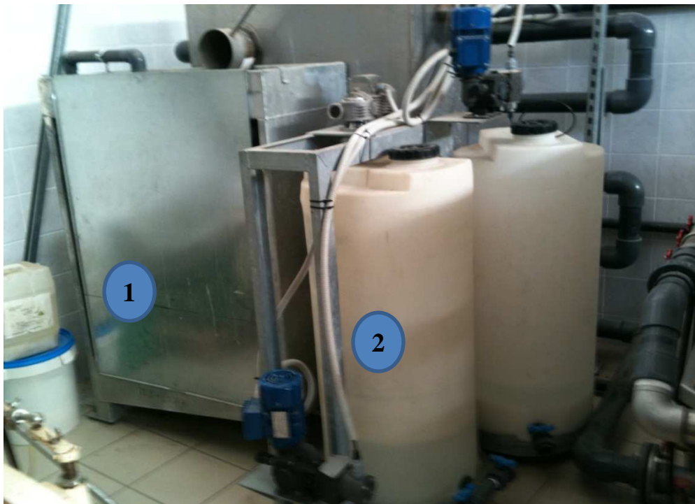
Σχήμα 12: Δεξαμενή εξισορρόπησης πρωτογενών λυμάτων πριν την είσοδο στη βιομηχανική μονάδα DAF.
