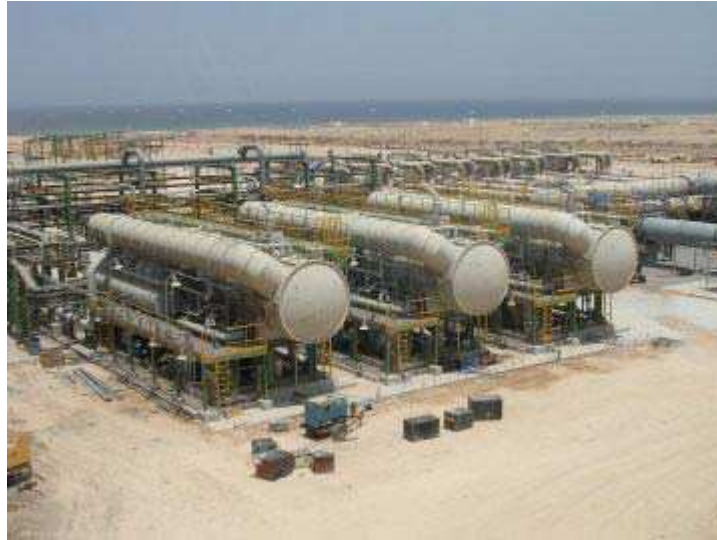
Εικόνα 1.3: Εγκατάσταση πολυβάθμιας εξάτμισης στο Ομάν [20]
