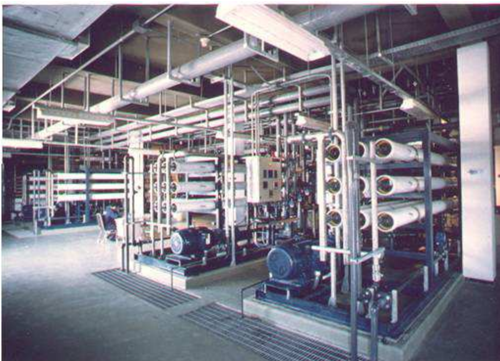
Εικόνα 1.16: Εγκαταστάσεις μονάδας αντίστροφης όσμωσης [7]
