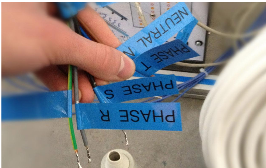
Εικόνα 3.3.1 Η τροφοδοσία ρεύματος της μονάδας
