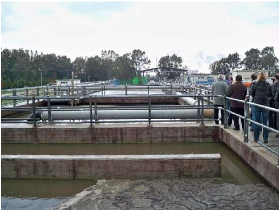
Εικόνα 4.8: Βιολογική μονάδα Αχέλειας
