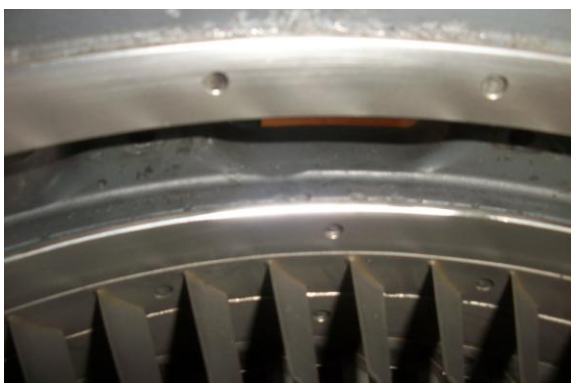
Εικόνα 4.18 : Διάβρωση στο εσωτερικό
