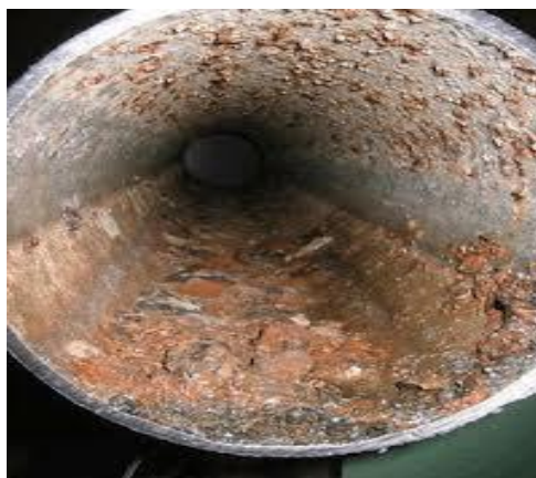
Εικόνα 1.6 : Ρευστομηχανική διάβρωση σωλήνα ΕΥΔΑΠ
