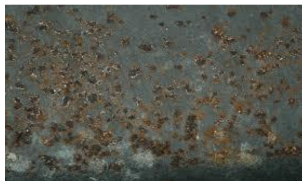
Εικόνα 3.3: Διάβρωσης με βελονισμό
