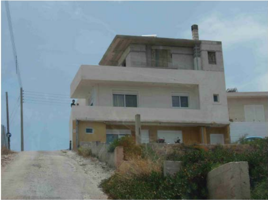
Παράνομη κατασκευή τρίτου ορόφου σε εκτός σχεδίου περιοχή
