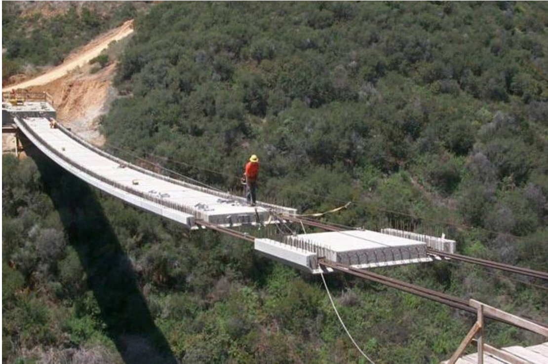
Εικόνα 1.32 μεταφορά του προκατασκευασμένου σπονδύλου στην κατάλληλη θέση κατά μήκος των ταινιοδιαδρόμων με τη βοήθεια σχοινιού έλξης και βοηθητικού σχοινιού
