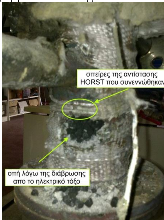
Εικόνα 2. 8 Διάβρωση του χαλύβδινου σωλήνα από το ηλεκτρικό τόξο που δημιούργησε η αντίσταση HORST στη βάση του ανοδικού σωλήνα
