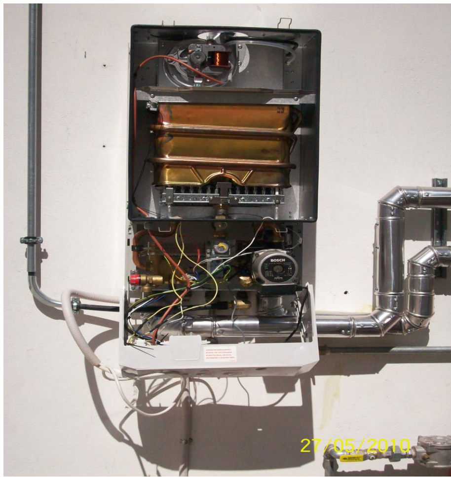
Εικόνα 2.11 : Λέβητας αερίου εγκατάστασης – εσωτερικά.
