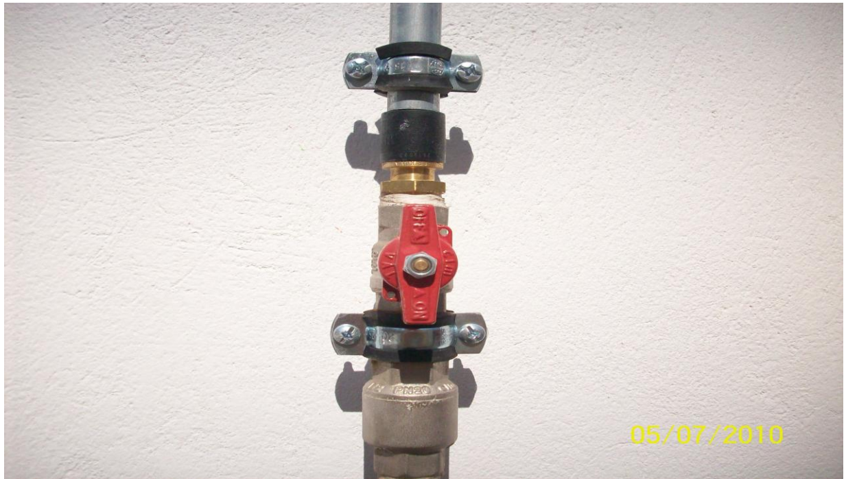
Εικόνα 2.2 : Βάνα ροής στο κύκλωμα του νερού.
