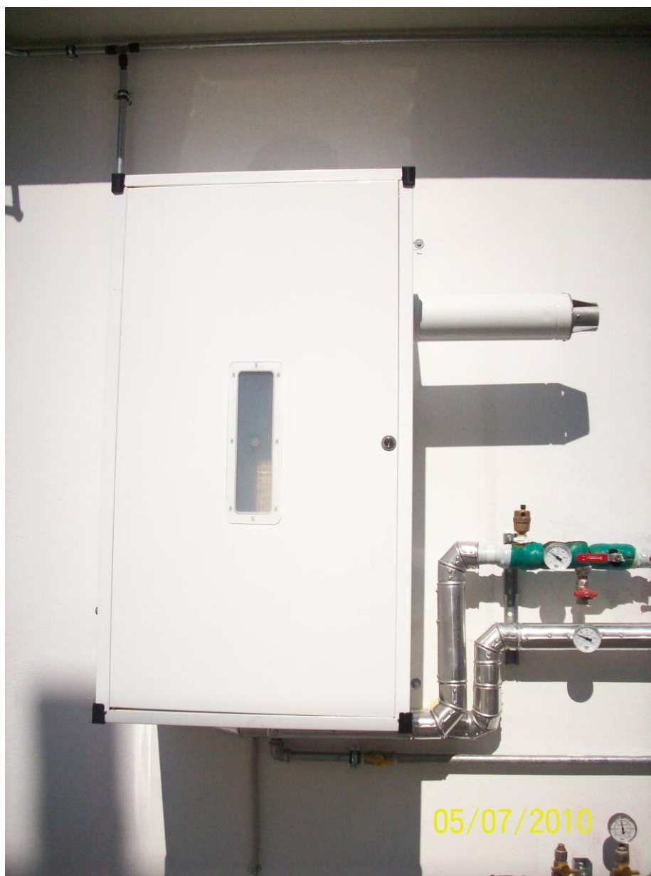
Εικόνα 2.12 : Λέβητας αερίου εγκατάστασης.
