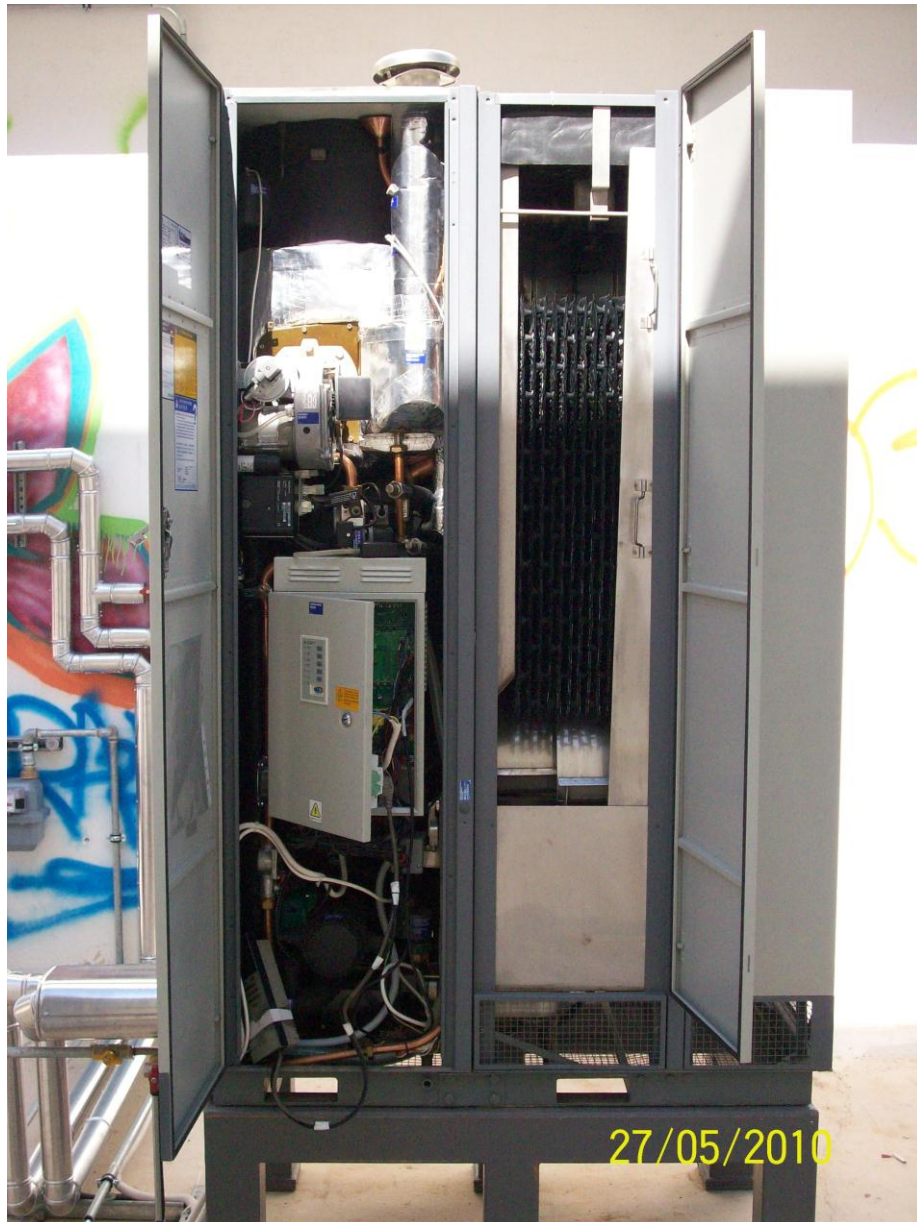
Εικόνα 3.2 : Ψυκτής απορροφησης BCT-16 - Εσωτερικά
