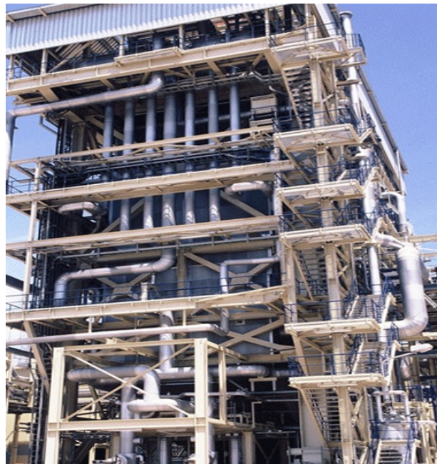
Σχήμα 3.3: Λέβητας ανάκτησης θερμότητας κατακόρυφου τύπου Figure 3.3: The vertical type heat recovery boiler (Πηγή: www.metka.gr )
