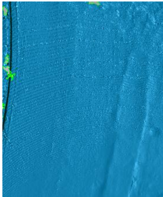
Εικόνα 6.52 Διαμήκειες ρηγματώσεις βόρειου τμήματος
