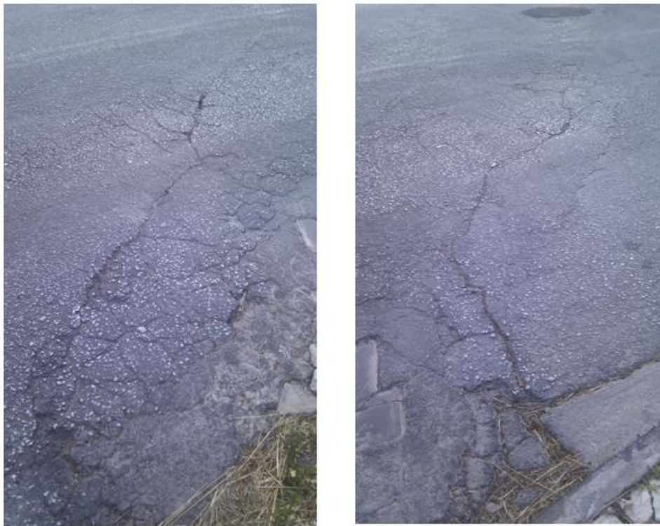
Εικόνα 6.13 Παραδείγματα ρωγμών λόγω υδάτινων ρευμάτων
