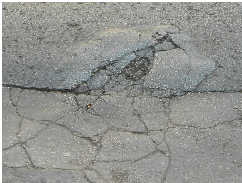
Εικόνα 6.29 Αποκολλήσεις ανώτερης στρώσης οδοστρωσίας
