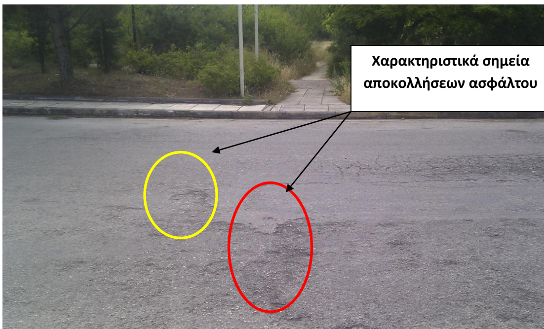
Εικόνα 6.44 Υφιστάμενη κατάσταση οδοστρώματος
