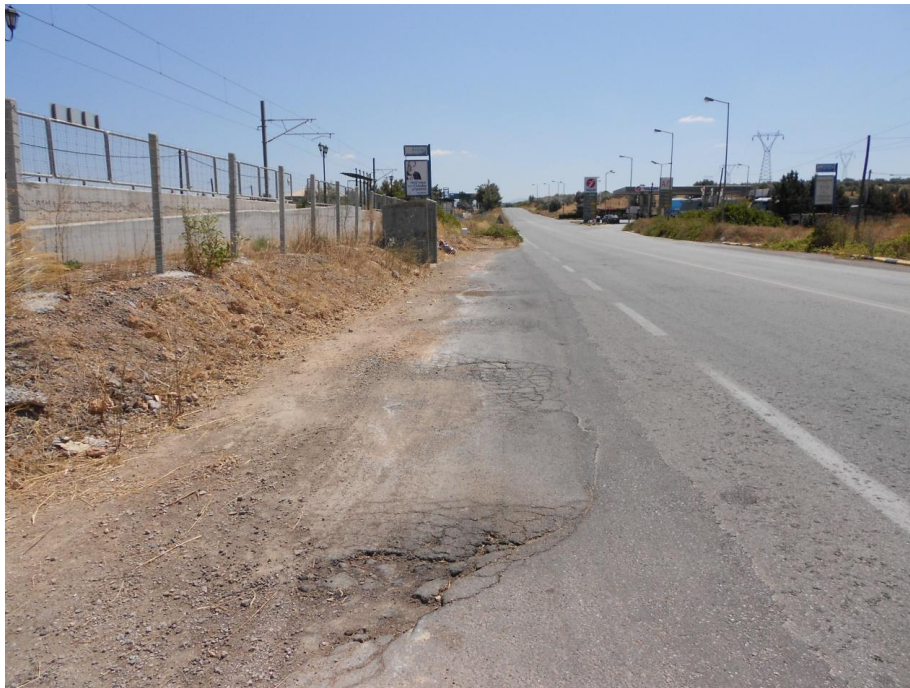
Εικόνα 6.26 Ρωγμές άκρου οδοστρώματος
