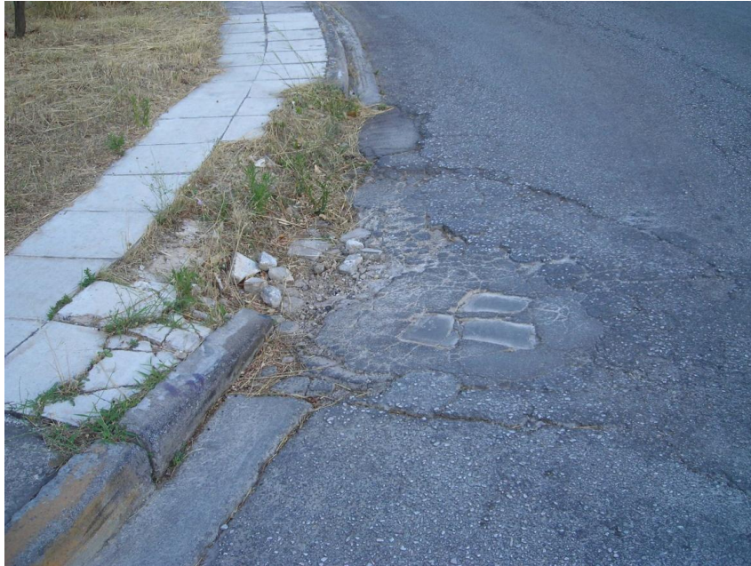
Εικόνα 6.17 Αστοχία στην άκρη του οδοστρώματος
