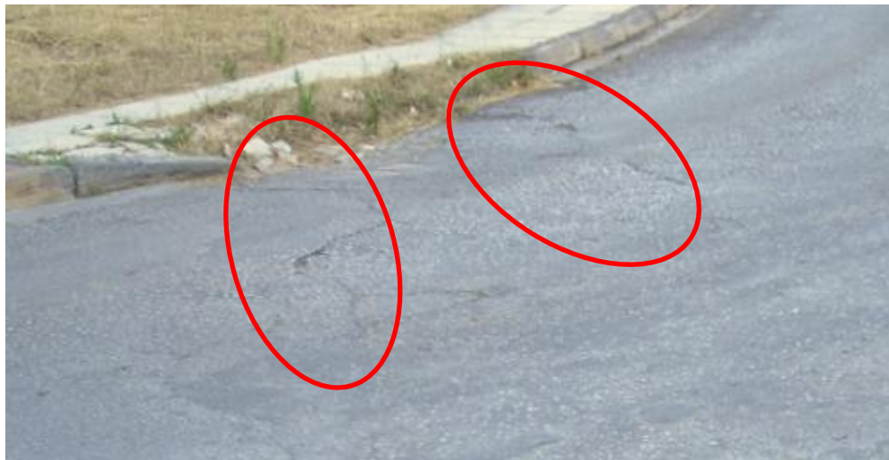
Εικόνα 6.48 Αναμενόμενα σημεία ρηγματώσεων
