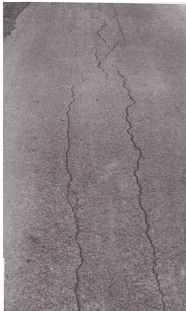
Εικόνα 5 Διαμήκειες ρωγμές σε εύκαμπτο οδόστρωμα (Πηγή: Yoder, Witczak, 1975)
