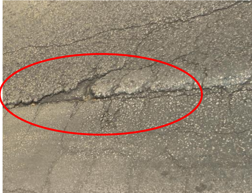
Εικόνα 6.32 Ρηγματώσεις λόγω υδάτων
