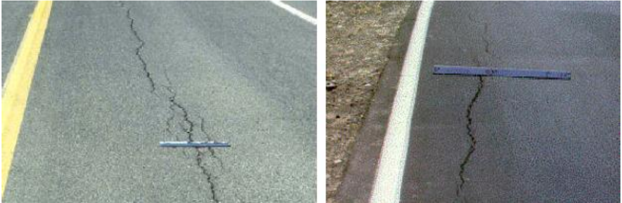
Εικόνα 4 Διαμήκειες ρωγμές (Πηγή: Ευαγγελίδης, 2004)
