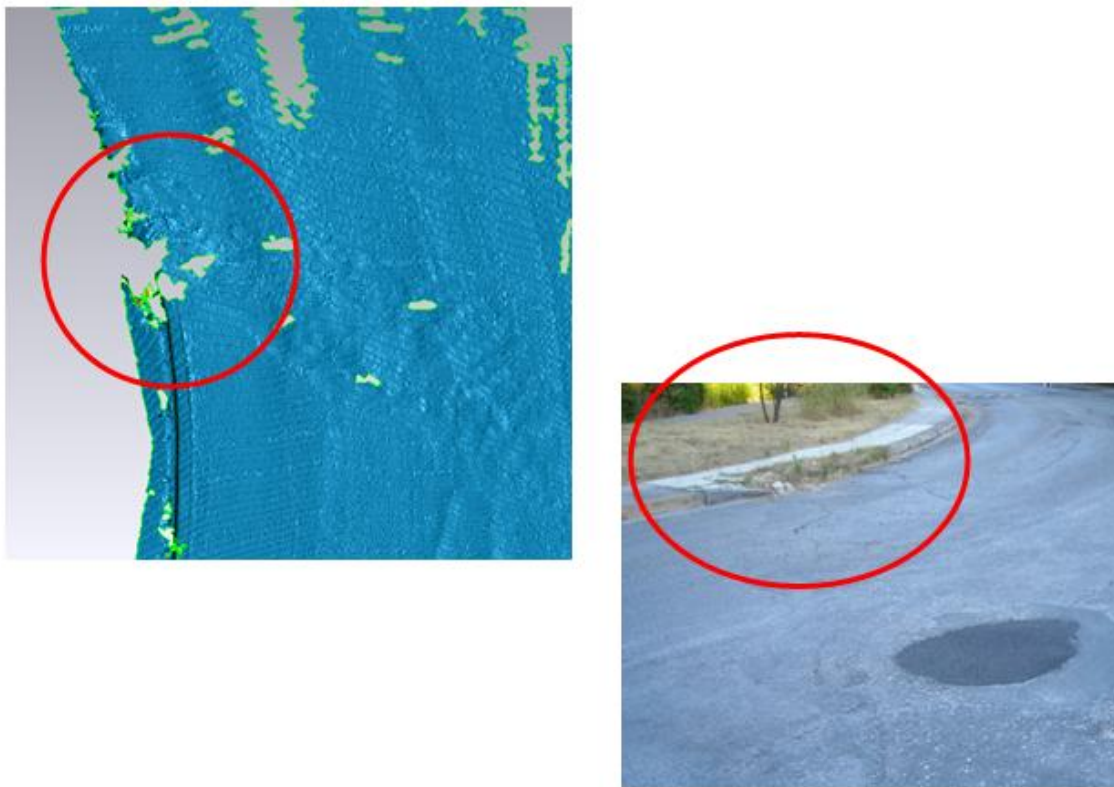
Εικόνα 6.53 Ρωγμές στην άκρη του οδοστρώματος
