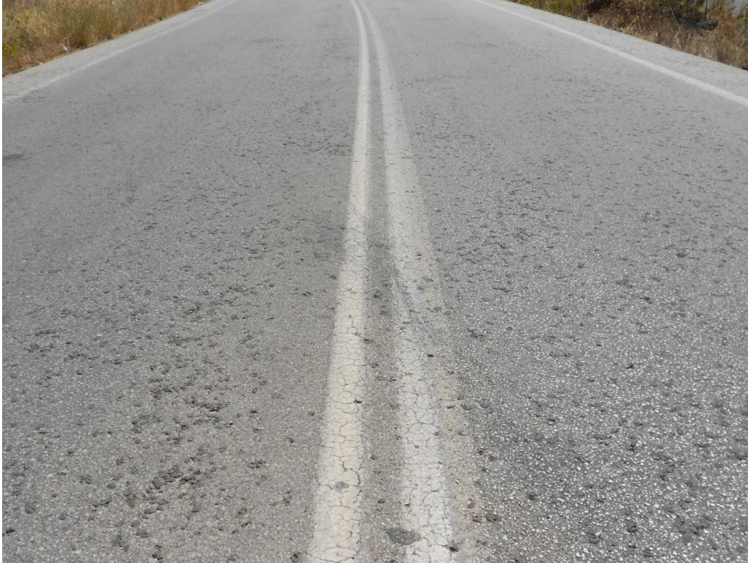
Εικόνα 4.10 Γενική εποπτεία κατάστασης οδοστρώματος
