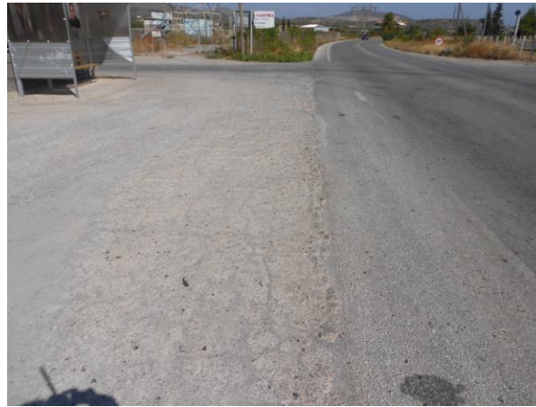
Εικόνα 6.25 Ρωγμές άκρου οδοστρώματος
