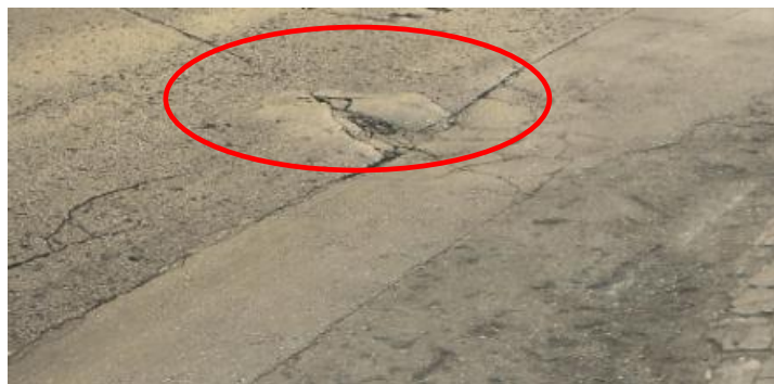
Εικόνα 6.31 Ρηγματώσεις λόγω υδάτων
