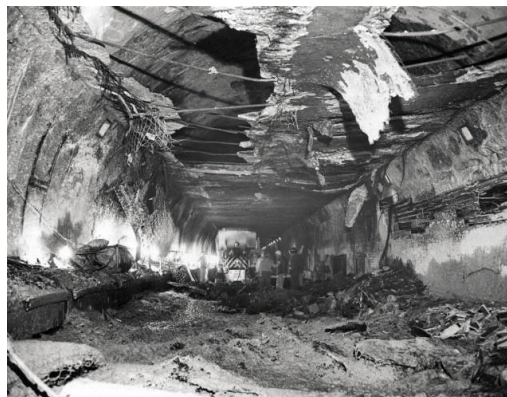
Εικόνα 3.6 Εσωτερική όψη της σήραγγας Holland μετά το ατύχημα (Holland tunnel 2012)
