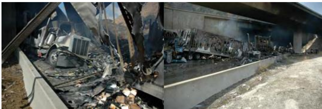
Εικόνα 3.20 Όψη της εξόδου της σήραγγας μετά την κατάσβεση της φωτιάς (United States Nuclear Regulatory Commission 2011)
