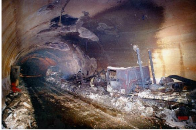
Εικόνα 3.11 Το εσωτερικό της σήραγγας Mont Blanc μετά την καταστροφή (Carvel 2004)
