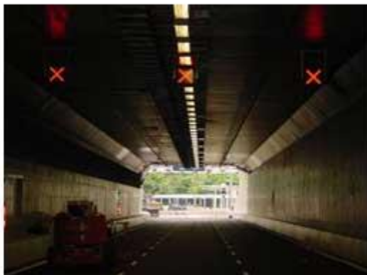
Εικόνα 3.30 Ενεργοποιημένοι κόκκινοι σηματοδότες εντός της σήραγγας
