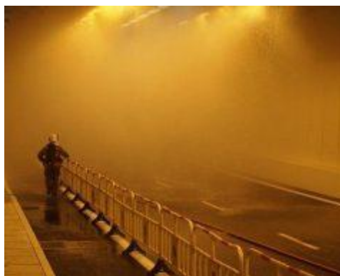
Εικόνα 3.46 Ενεργοποιημένο σύστημα καταιονισμού
