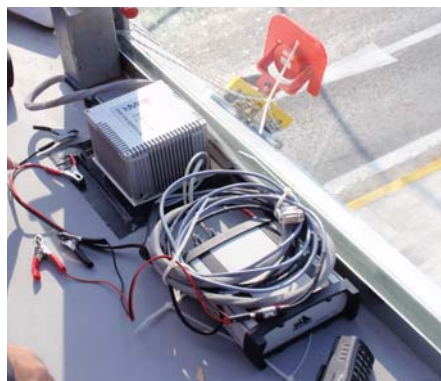
εικόνα 5.15- θέση αδρανειακής μονάδας
