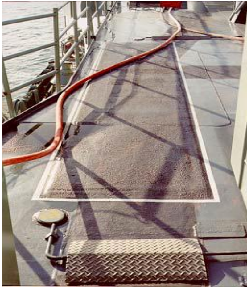
Εικόνα 7 Επίθεμα τοποθετημένο στο διάδρομο υπερκατασκευής φρεγάτας
