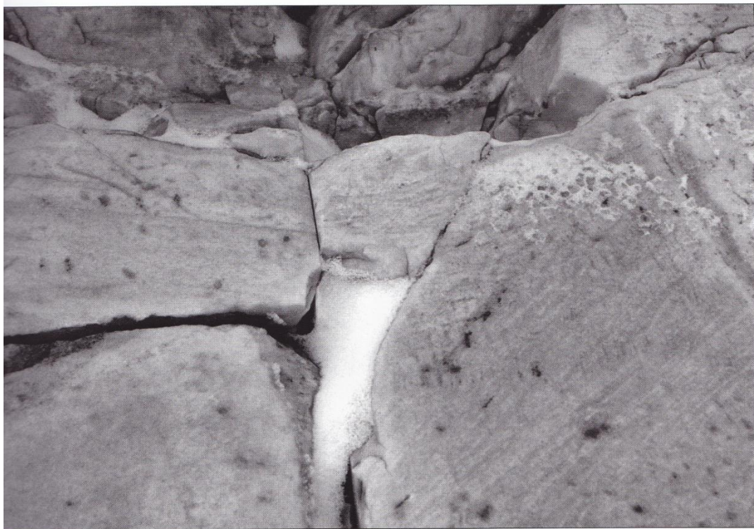
Εικ.1.6: Διεύρυνση ρηγμάτων από τον παγετό. [2]
