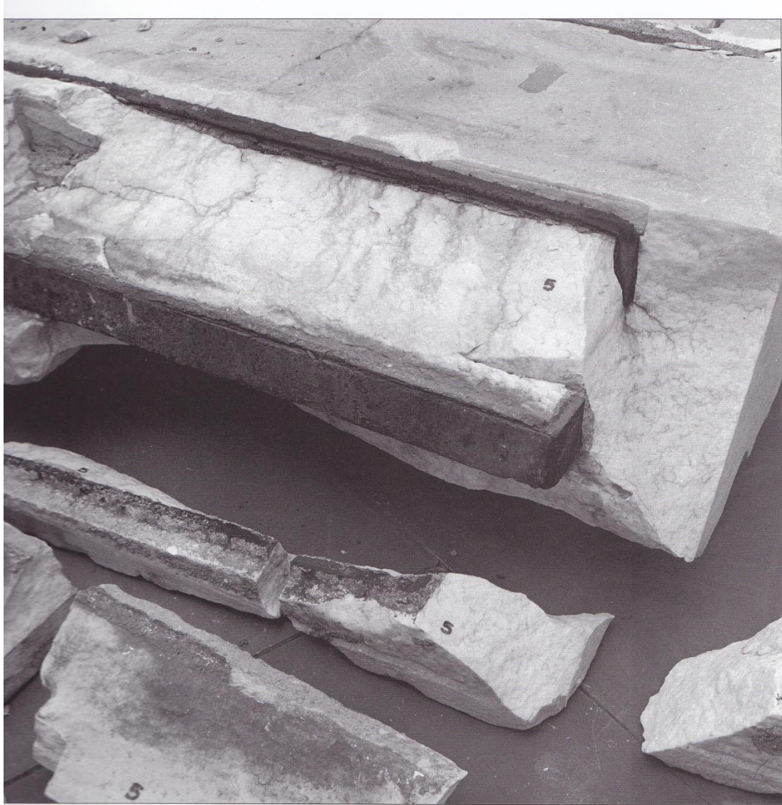
Εικ.1.12: Θραύση γείσου στη διόγκωση από οξείδωση σιδηρών συνδέσμων, παλαιότερων αναστηλώσεων. [2]
