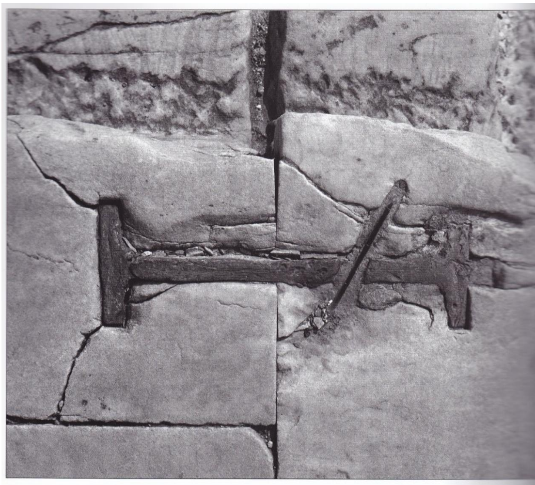
Εικ.1.11: Ρηγματώσεις του μαρμάρου οφειλόμενες στη διάγκωση των σιδηρών στοιχείων. [2]
