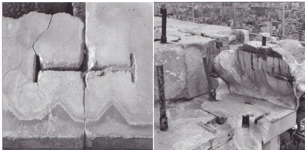
Εικ.1.13-1.14: Θραύσεις οφειλόμενες σε διόγκωση μεταλλικών στοιχείων. [2]
