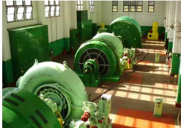
Εικόνα 4.8 Το εσωτερικό του σταθμού παραγωγής. Διακρίνονται οι τρεις υδροστροβίλοι τύπου Francis
