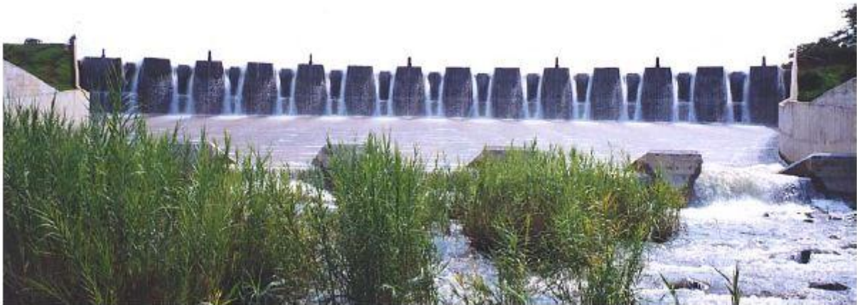
Εικόνα 3.1 Σύστημα ανατρεπόμενων θυροφραγμάτων εγκατεστημένο στη στέψη μετωπικού υπερχειλιστή φράγματος
